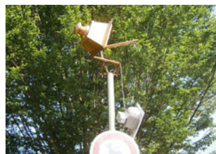
Candélabre vandalisé rue des Écoles
